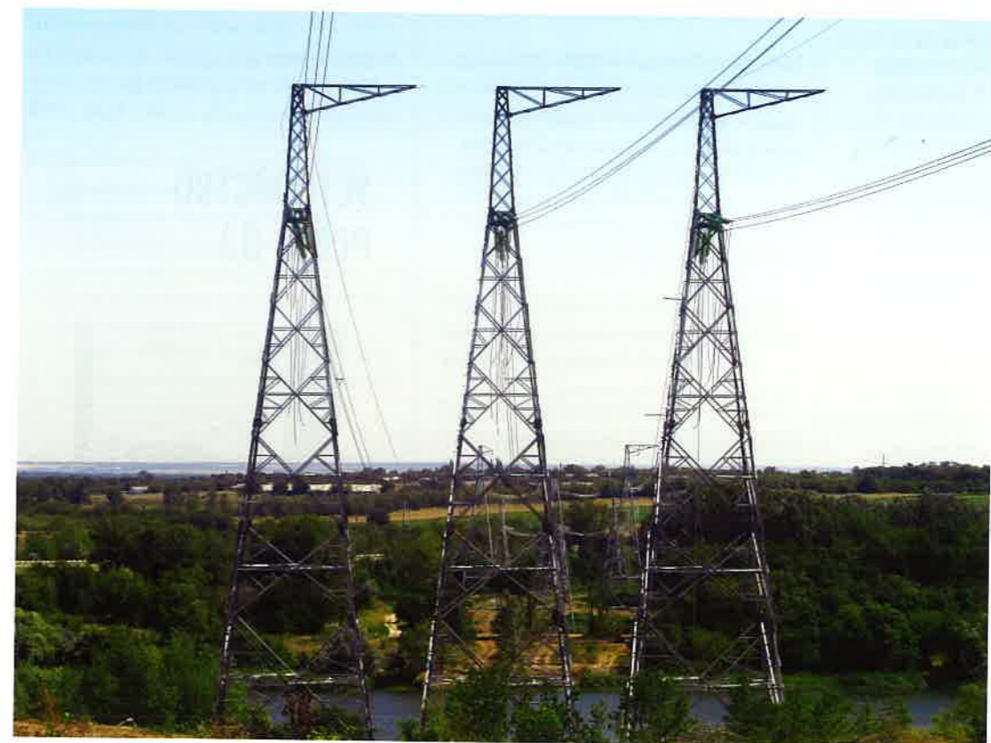
Рис. 3 Опоры спецперехода через Северский Донец
