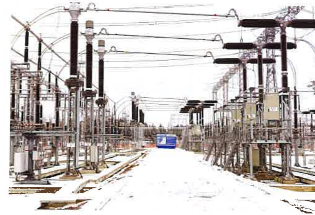
Рис. 2 Подстанция 330 кВ Кингисеппская
