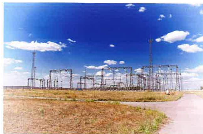
Рис. 1 Подстанция 500 кВ Ростовская
